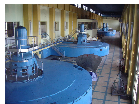
Salle des machines de la centrale hydroélectrique de Fessenheim. On reconnaît les générateurs peints en bleu.
